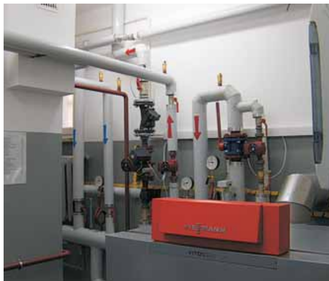
Kotłownia Przychodni Miejskiej Nr 2
